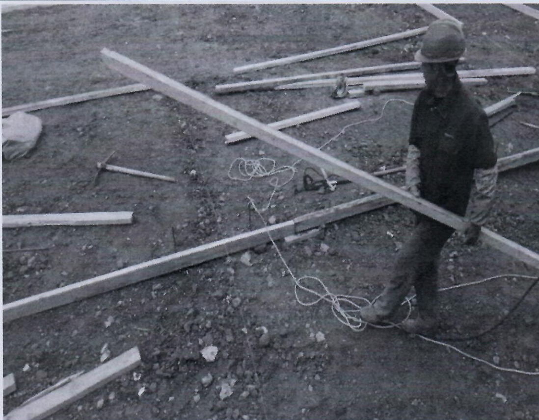
施工现场电线凌乱。(图 3)
