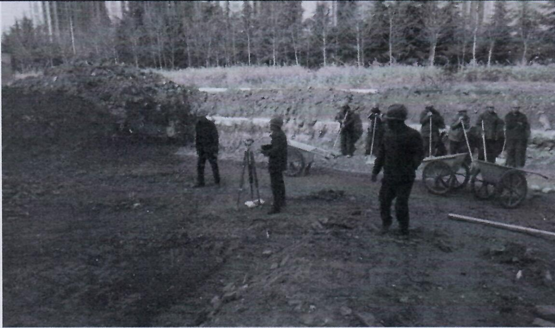
施工现场发现抽烟的人员。(第二个人员)(图 5)
