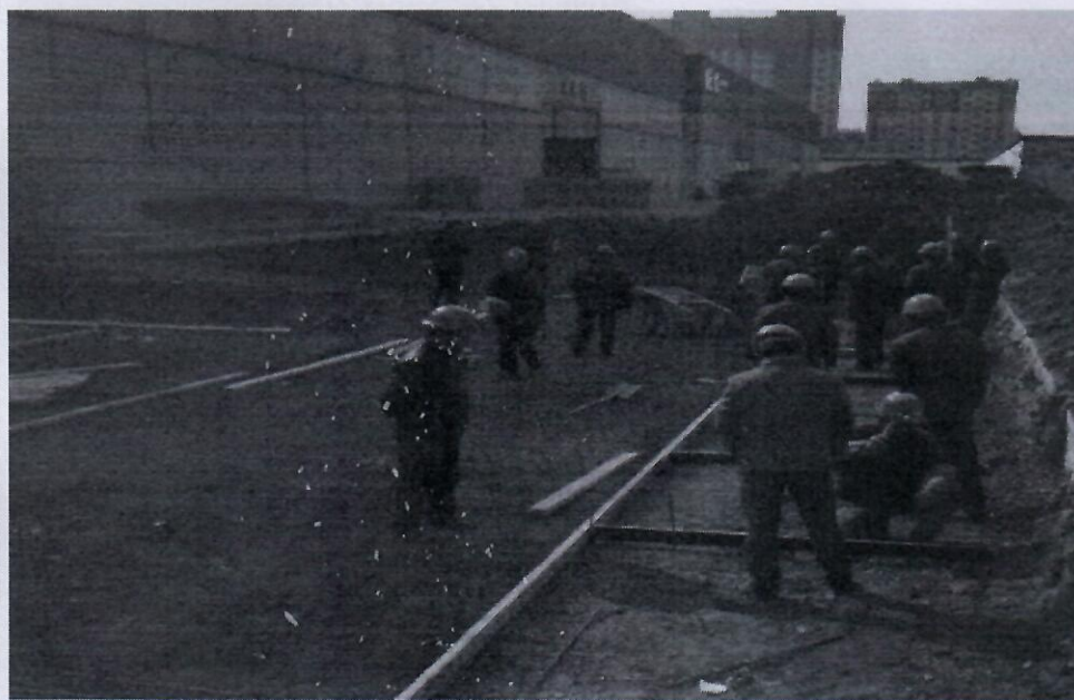
施工现场中发现有不戴安全帽的人员。(最边上一个人员)(图 4)
