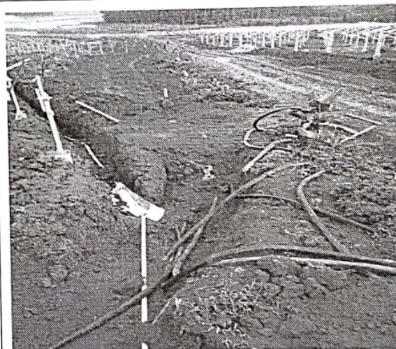
部分区电缆线布置太乱
