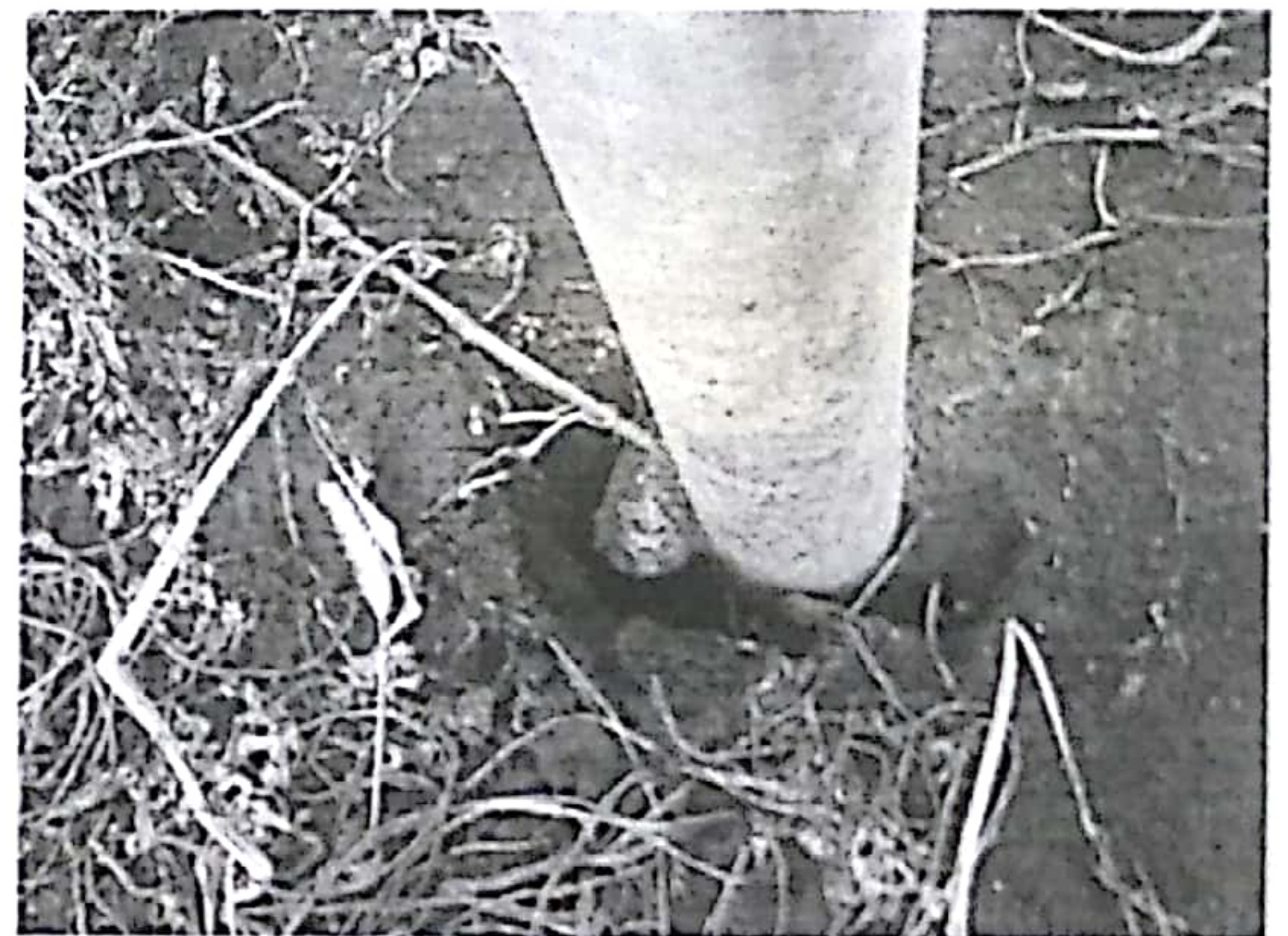
基础土壤回填压实度不够、疏松
