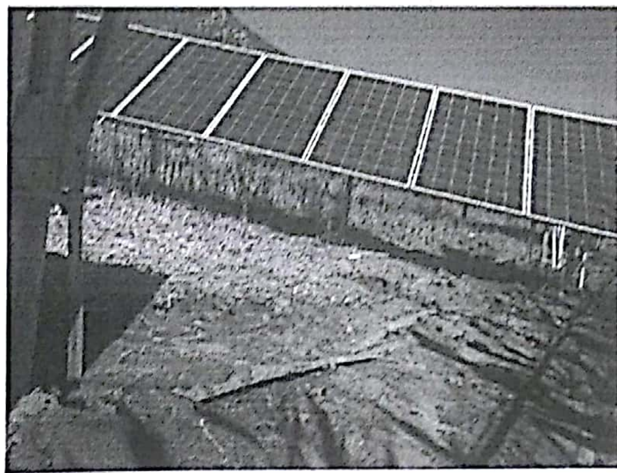
接地网扁铁埋设过浅、部分地方直接外露
