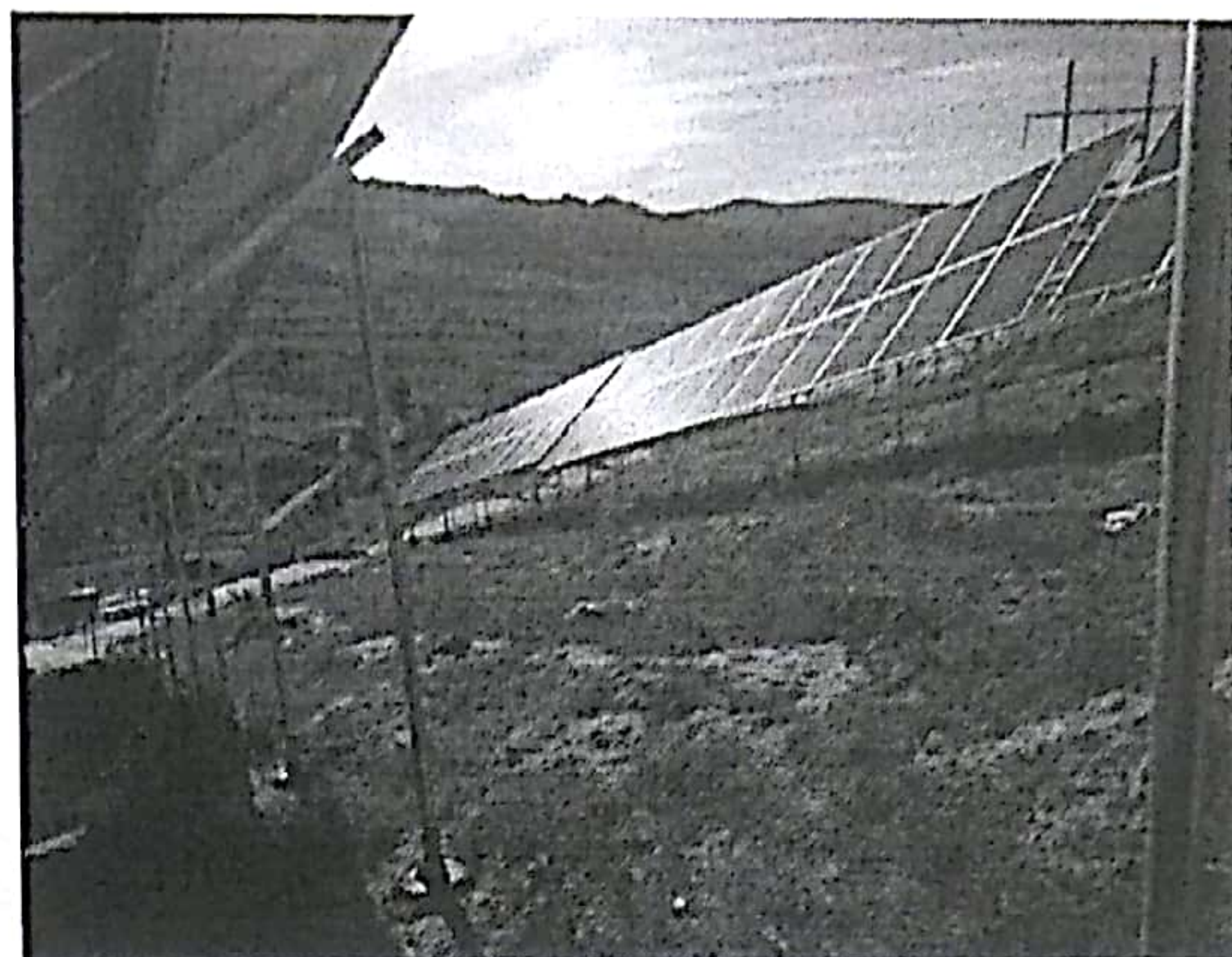
支架立柱间拉杆未安装
