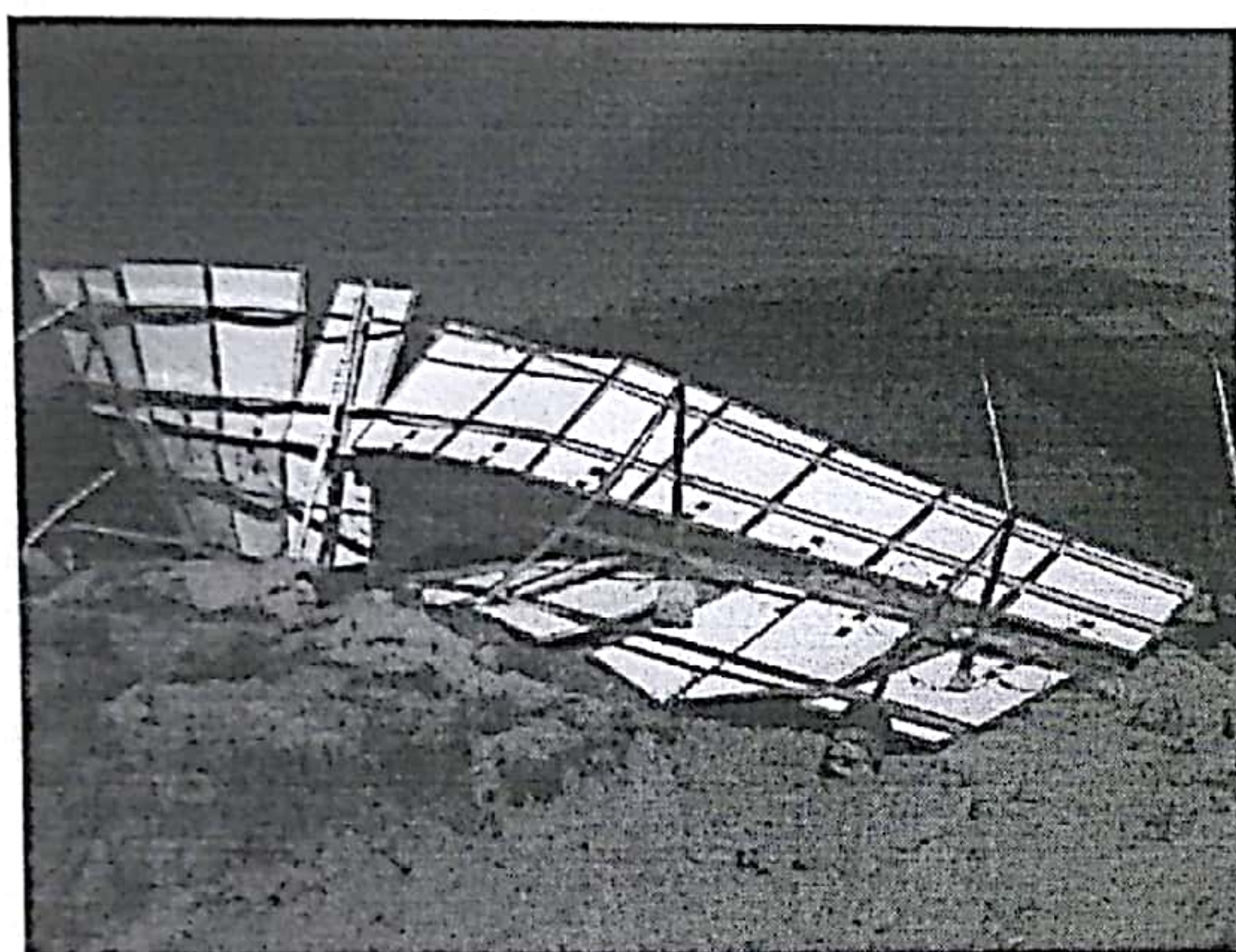
基础深度未考虑现场地形差导致遇大风整体倾倒
