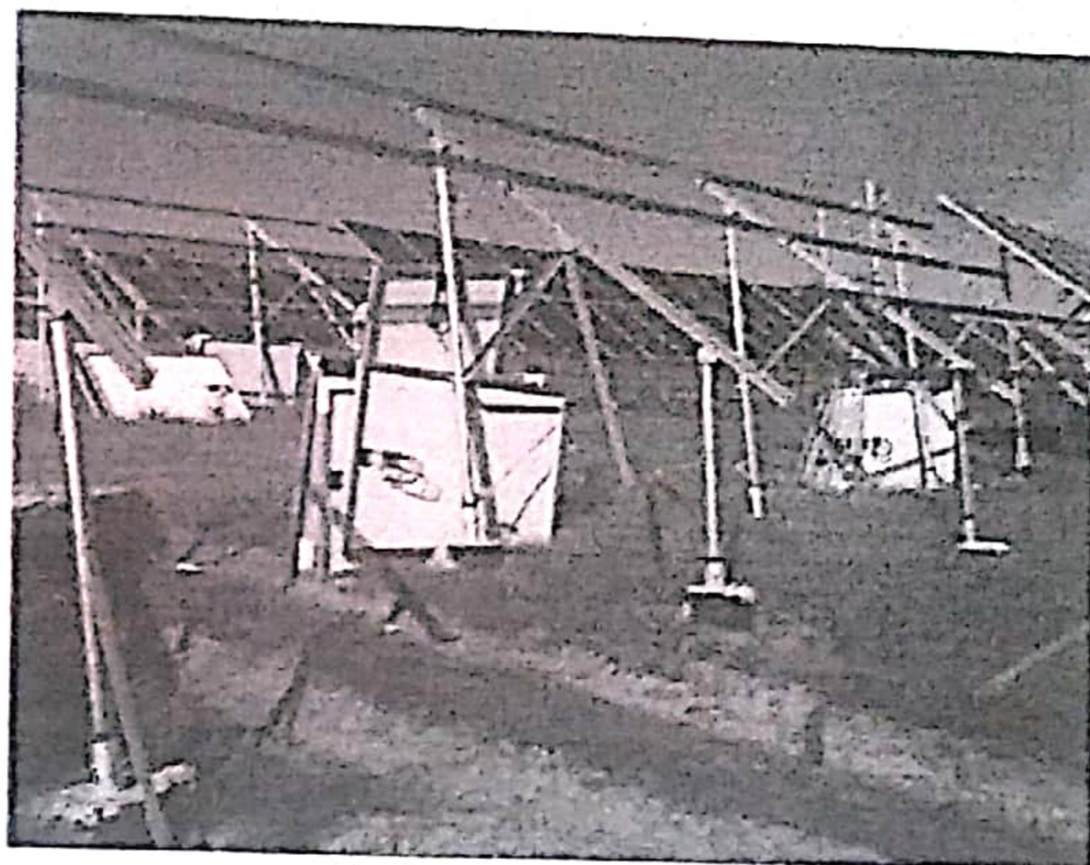
现场组件板堆放随意
