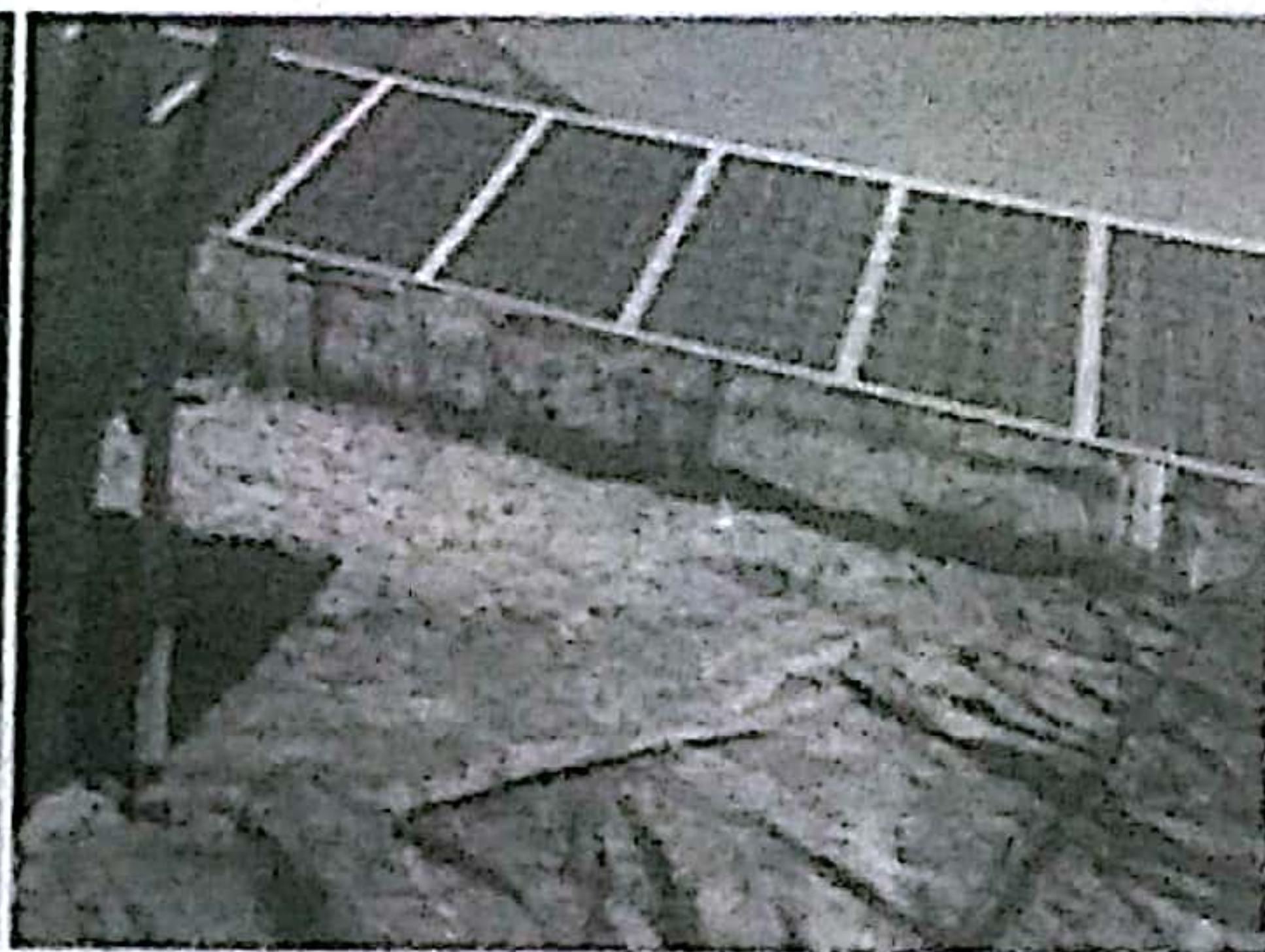
部分地方接地扁铁埋设过浅
