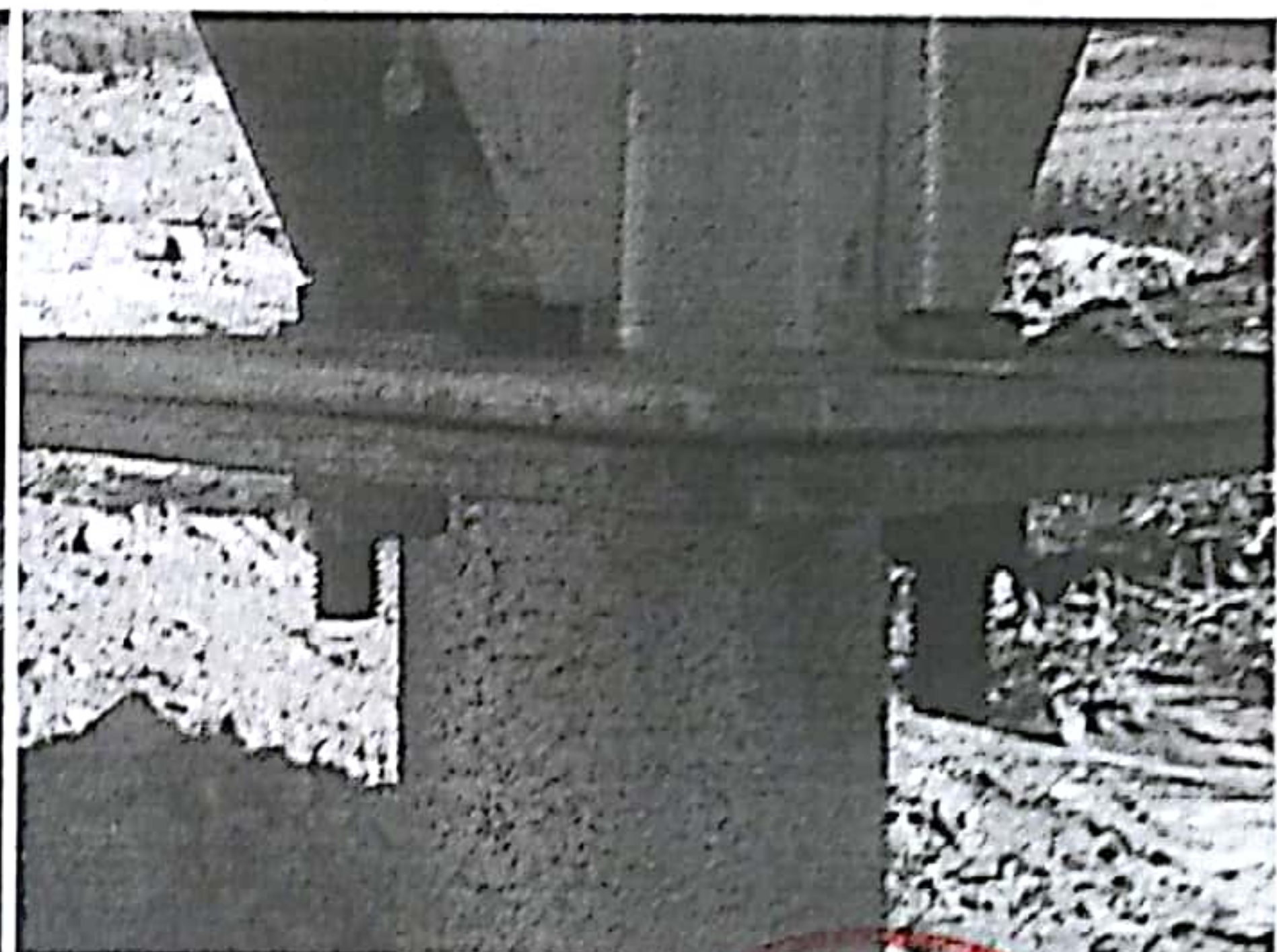
部分螺栓生锈
