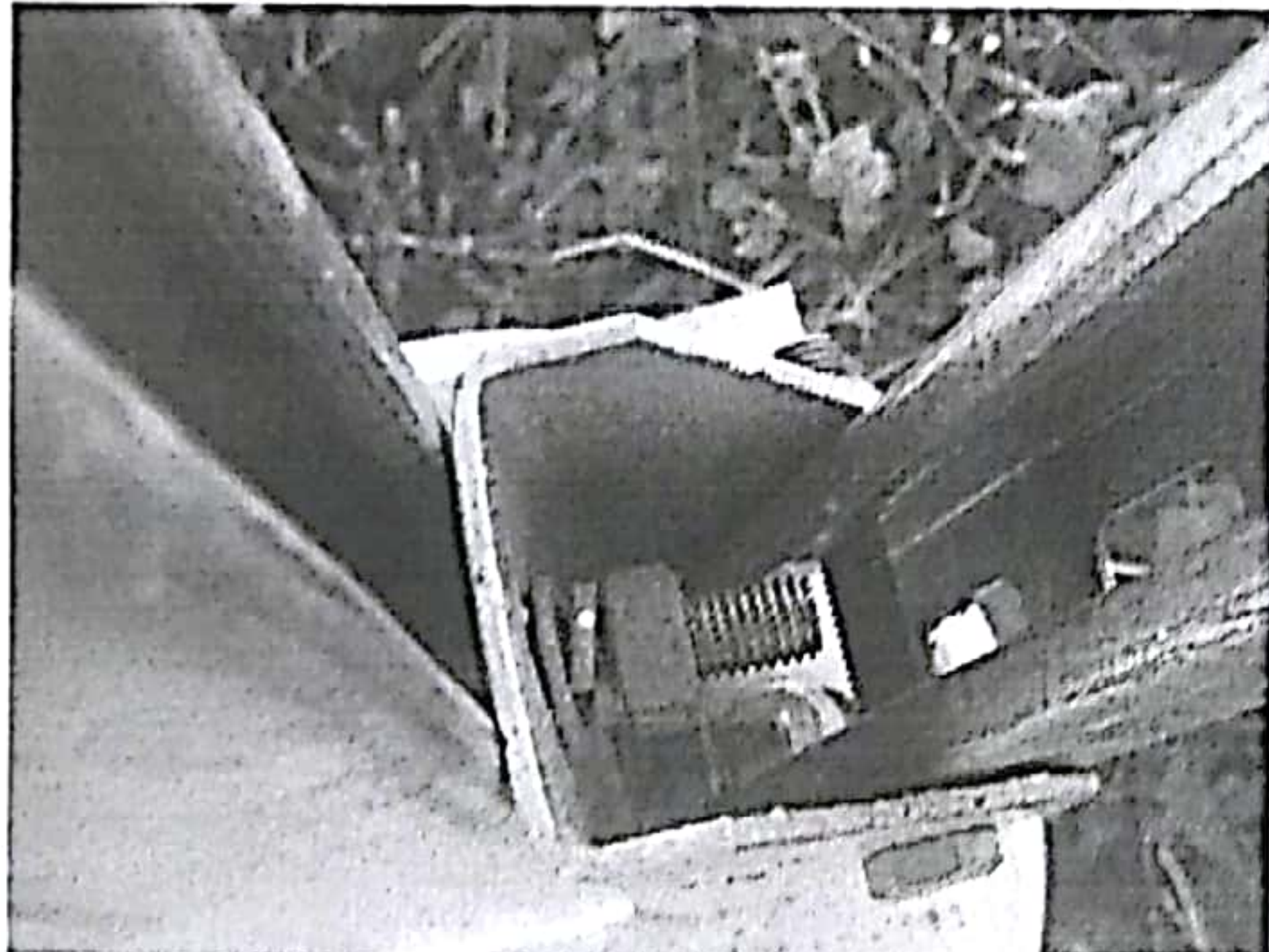
部分螺栓未紧固
