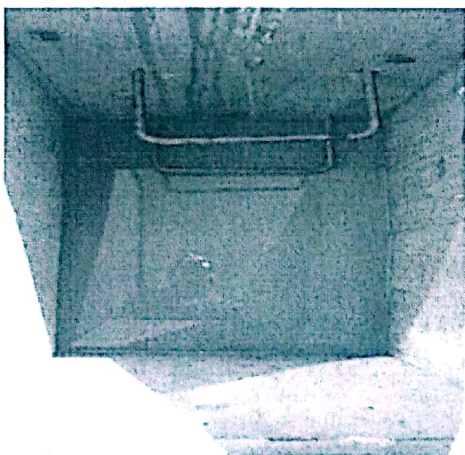
箱变基础内的积水
