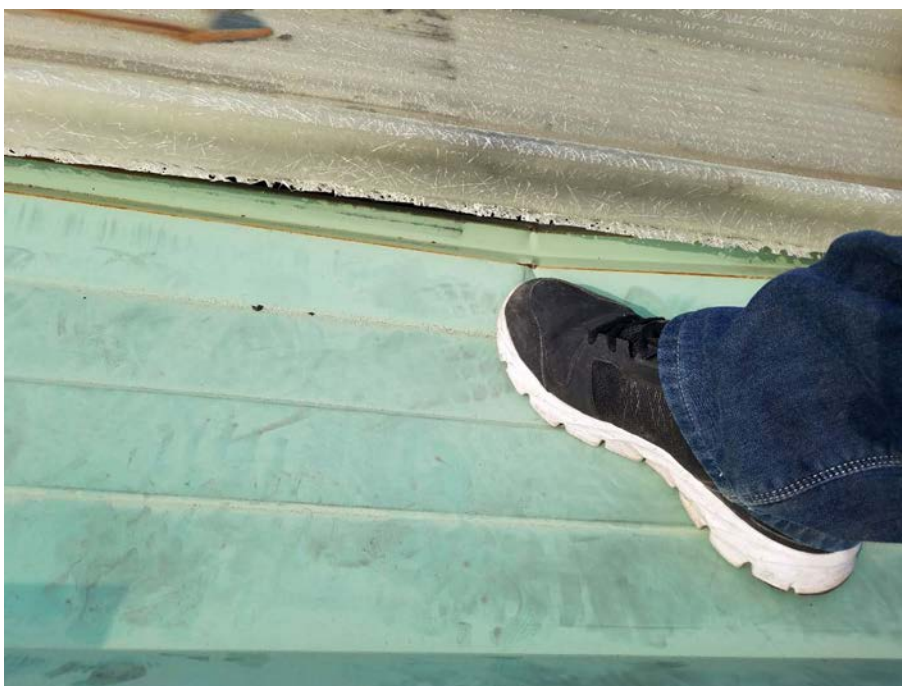
屋面彩钢瓦踩踏造成损坏，人员行走可能踏空坠落
