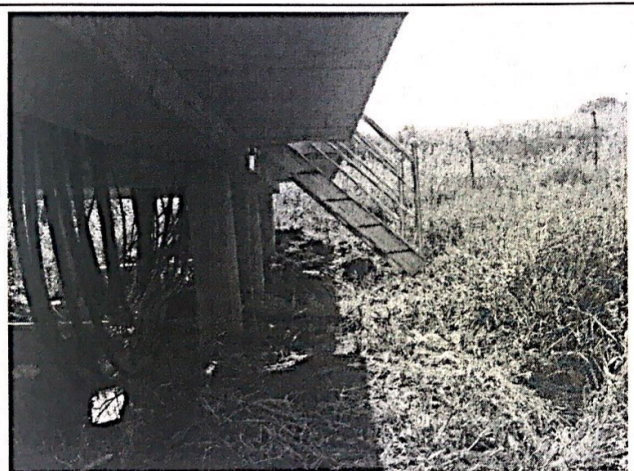
图 3 爬梯处于悬空状态
