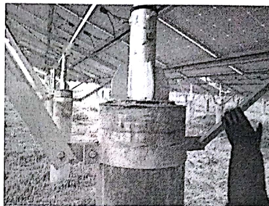
桩帽生锈、未满焊缝
