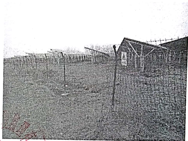
场区围栏施工未完成
