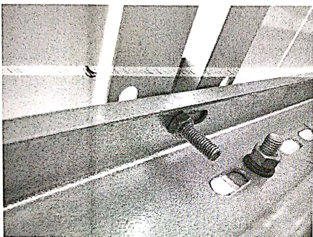
组件压块固定螺栓缺少垫片
