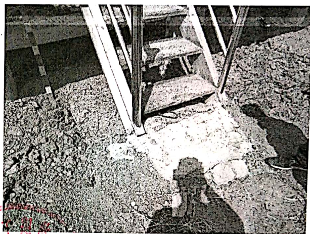
箱逆变平台爬梯基础不合格
