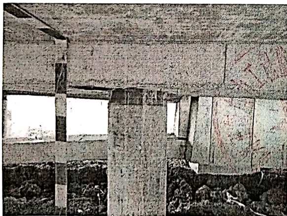
箱逆变平台预埋件除锈防腐未做
