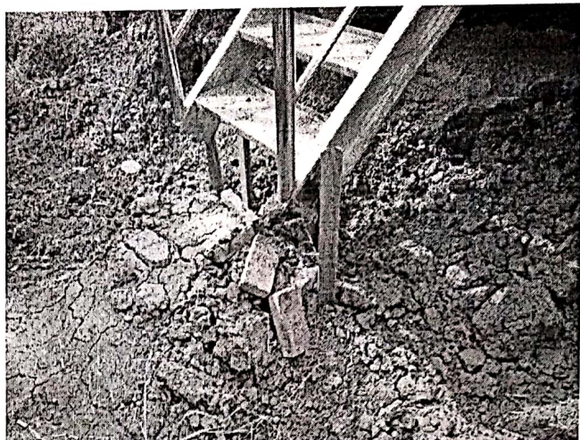
箱逆变平台爬梯基础未做
