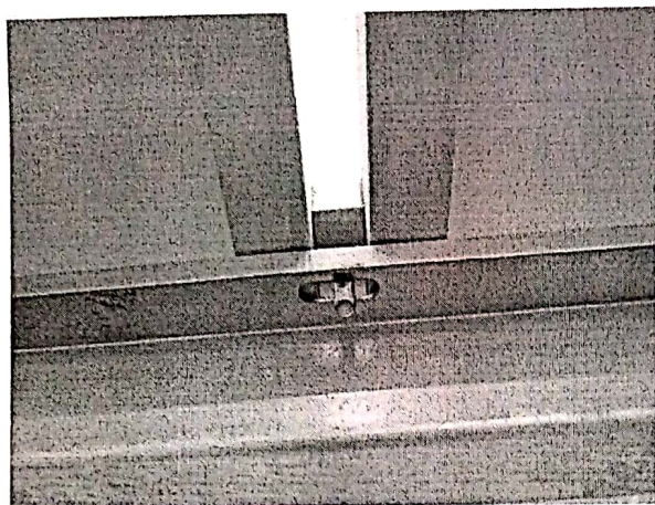
组件压块缺少螺栓未紧固
