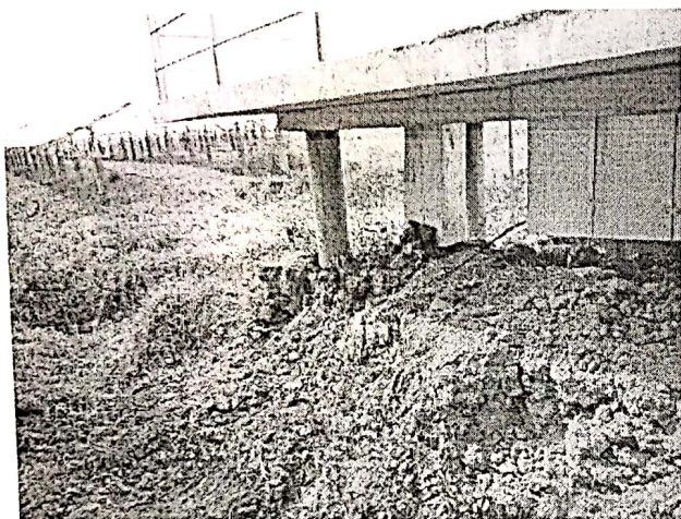
箱逆变基础旁边存在塌落现象
