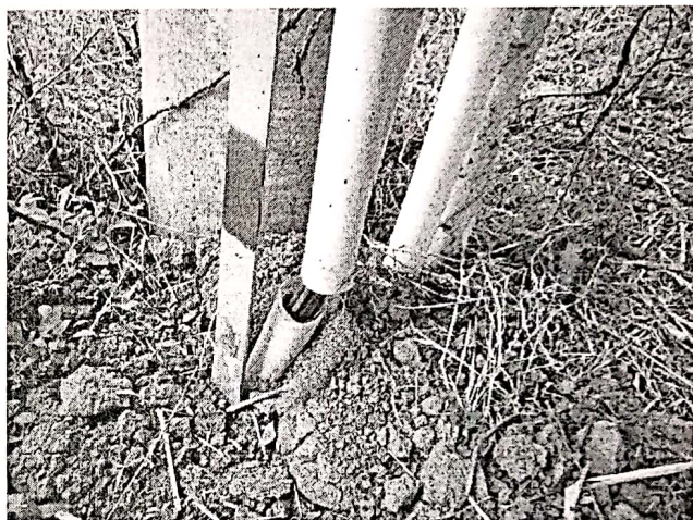
场区电缆套管破损
