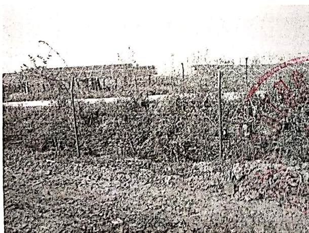
场区围栏安装不到位
