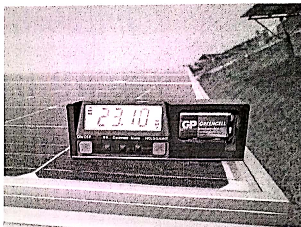
组件安装倾斜角度不合格
