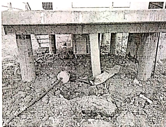
箱逆变平台处杂物未清理
