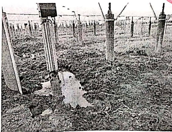
场区汇流箱处积水严重
