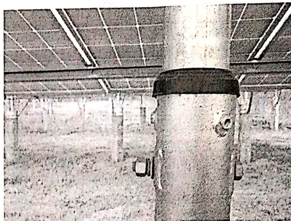
支架立柱固定螺栓缺失未紧固
