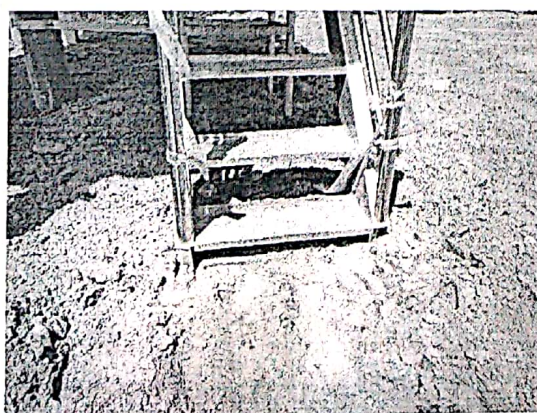
36 区箱逆变爬梯基础未完成
