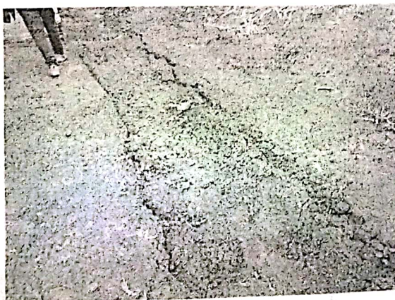
场区电缆回填不到位
