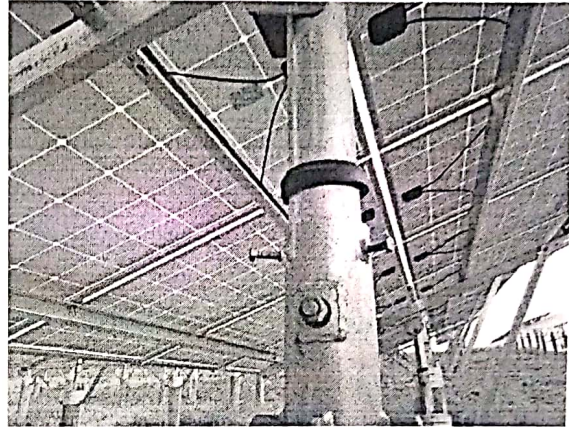
防水橡胶圈安装不到位
