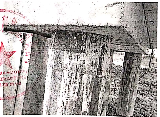
预埋管桩桩头未防腐
