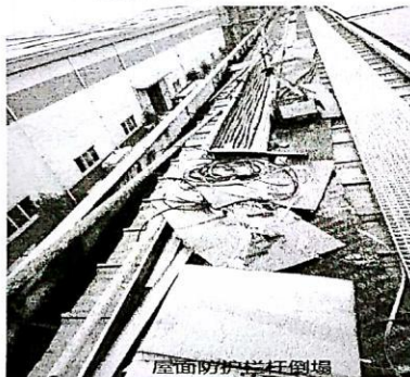
屋面防护栏杆倒塌 屋面防护栏杆需加固
