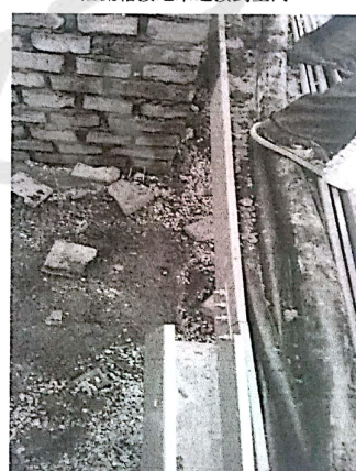
低压电缆和高压电缆未分开敷设
