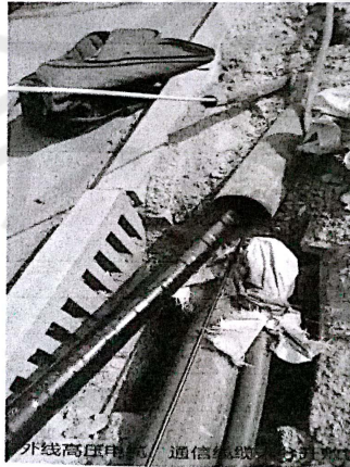
10KV 高压电力电缆和 24 芯光纤光缆未分开敷设
