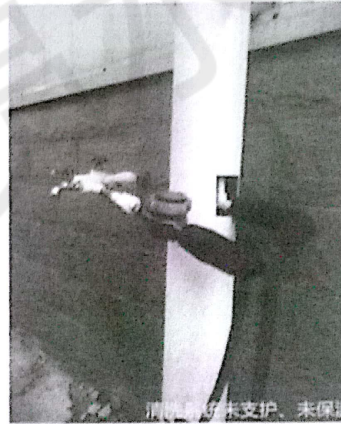
管道需支护、需保温
