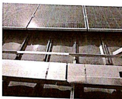
桥架盖板间距过大
