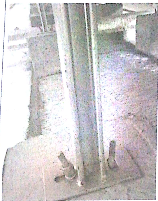
支架支墩螺栓未紧固
