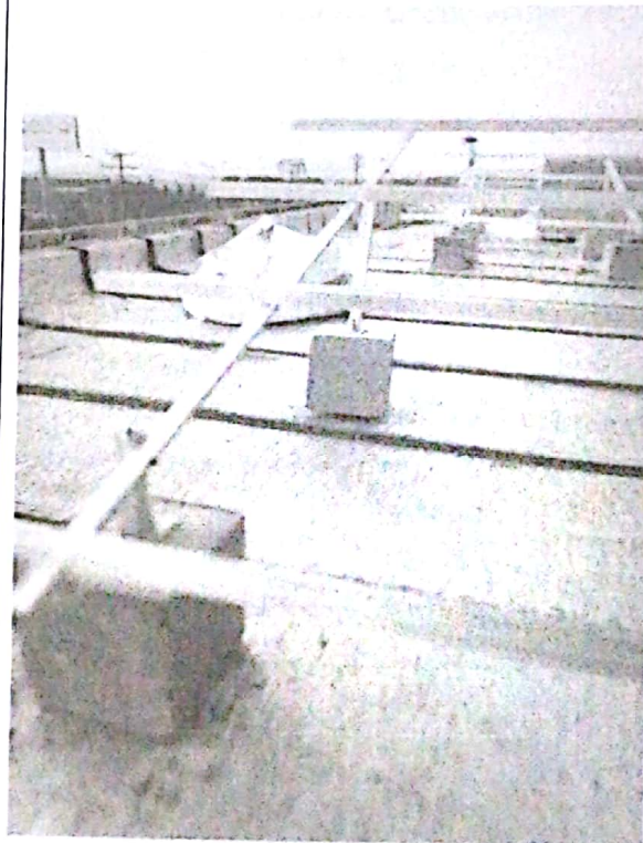
支墩轴线偏差过大
