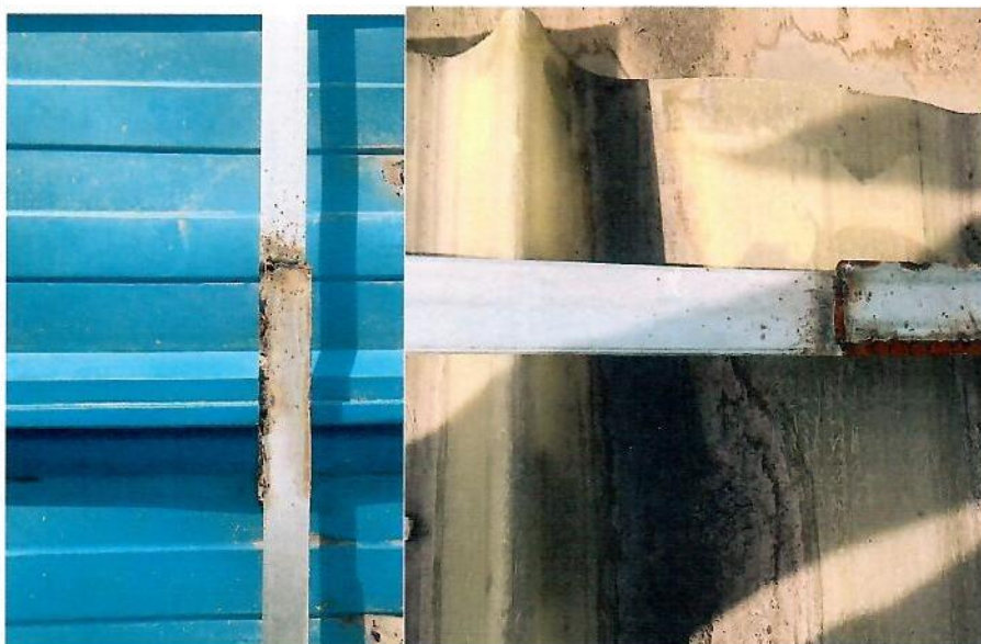
7. 接地扁铁未刷防腐漆
