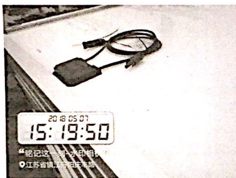
松卜组件背板向上堆放，积水严重，可能会导致组件连接线路氧化。
