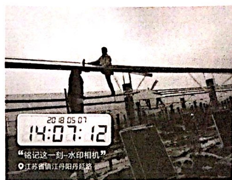
联兴组件安装野蛮施工（安装过程中用脚踹组件），施工人员未按要求佩戴安全帽
