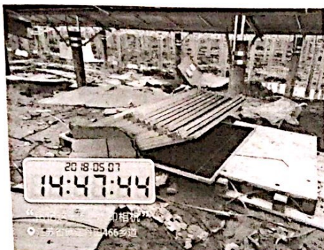
快庄组件摆放不符合要求，会导致组件隐裂
