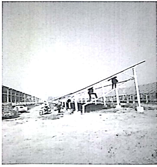
光伏缆敷设，部分人员未戴安全帽
