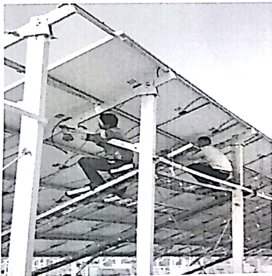
组件安装，部分施工人员未系安全带，未戴安全帽
