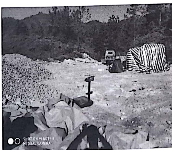
4、已设置混凝土材料过磅称
