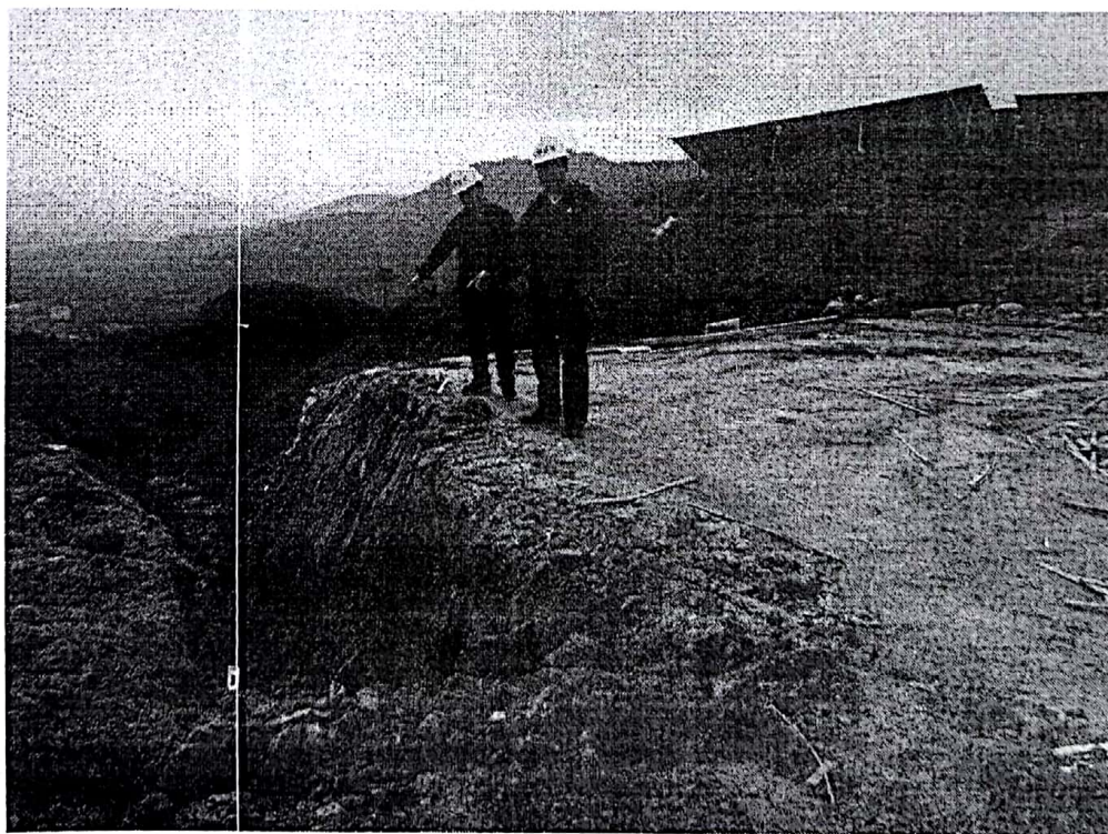
排水沟下雨容易塌方
