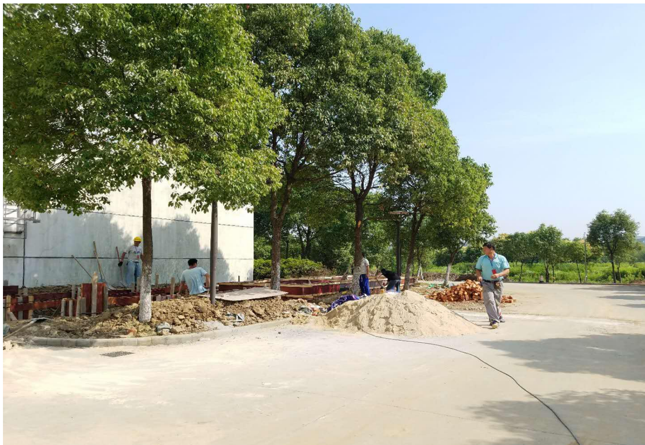
工人施工未佩戴安全帽
