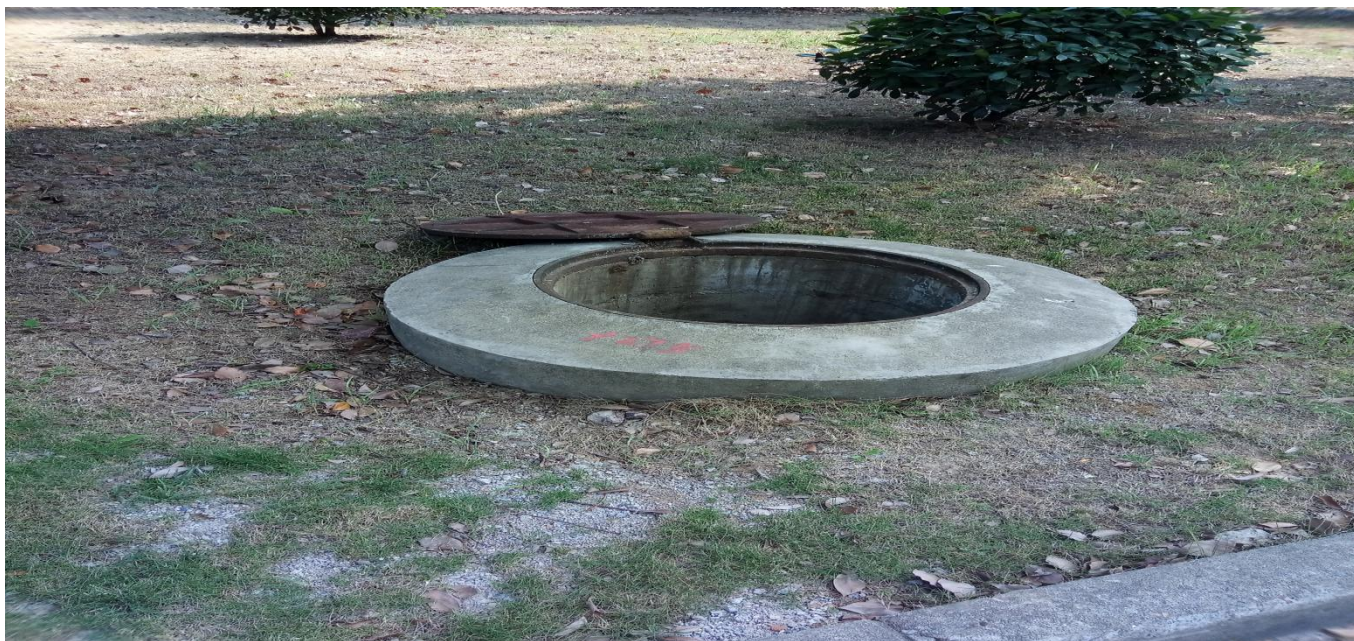
雨水井使用后未能闭合且周围无警示标志
