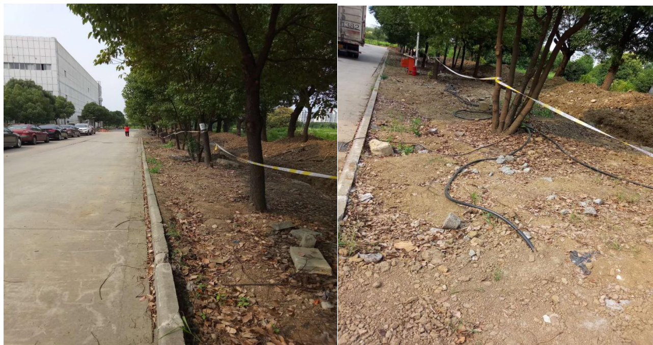
现场临时用电电缆没有架空敷设
