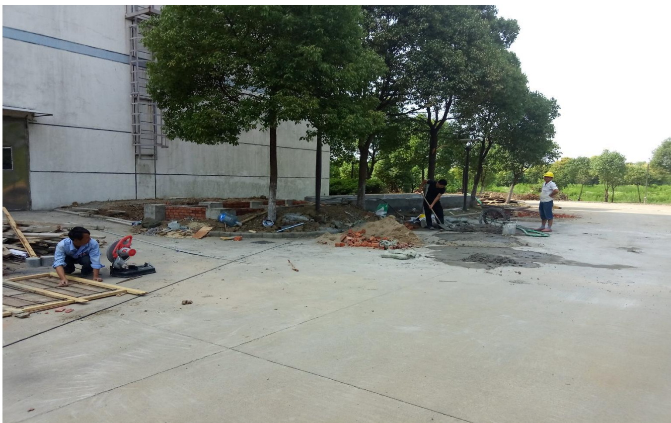
多次要求后设备基础部分施工工人仍未佩戴安全帽
