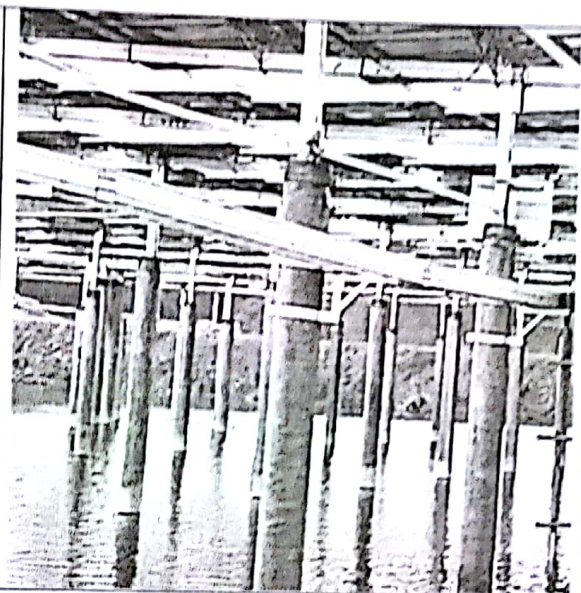
电缆桥架水平方向不平整
