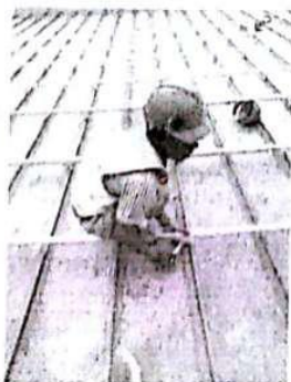
专人检查未紧固的支架轨道
