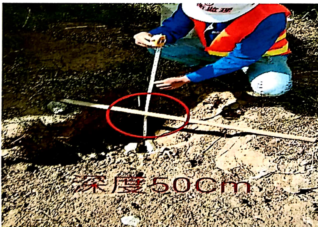
过路直埋电缆沟开挖深度不符合设计要求，热镀锌钢管两端管口未进行处理
