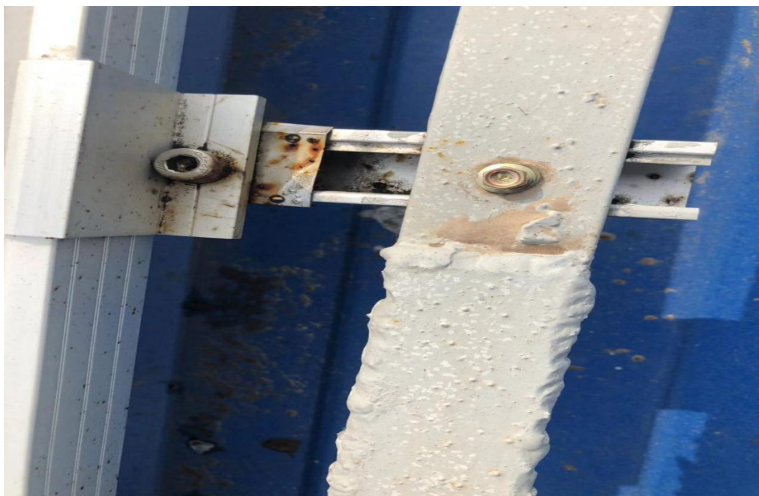
11. 直流线缆部分未绑扎好
