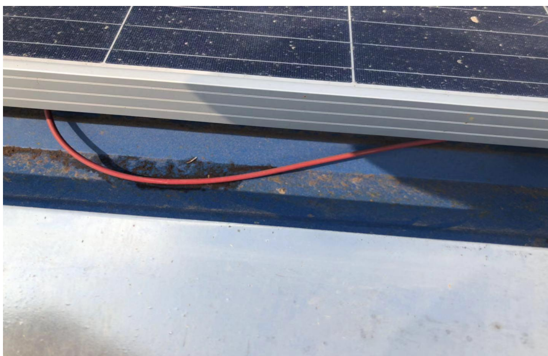
12. 清洗系统，管内水未抽排出去且保温材料脱落
