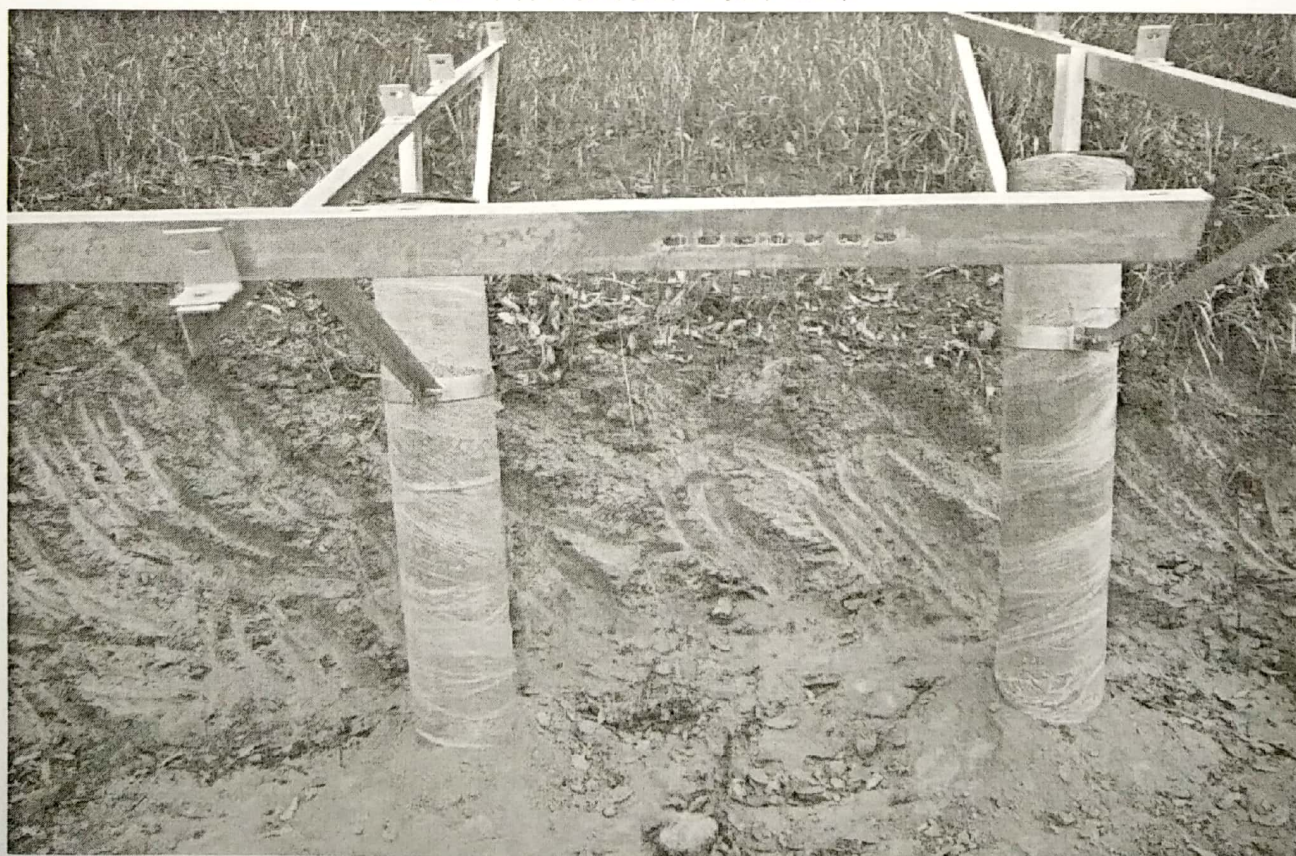
桩距较小，造成檩条无法安装
