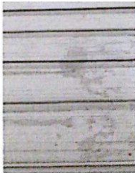
处理前压损处
