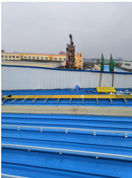
屋面女儿墙低于 1.2m 处未设置安全防护
