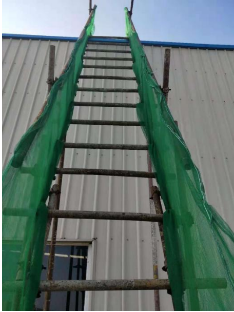
爬梯与地面角度较大
