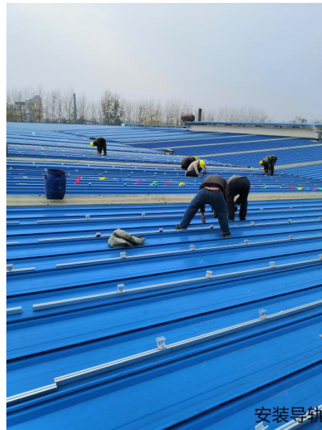
施工人员未穿戴劳保衣
