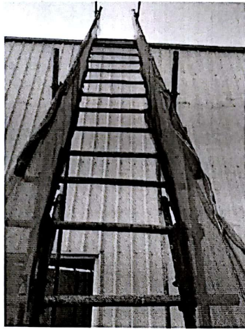
爬梯与地面角度较大
