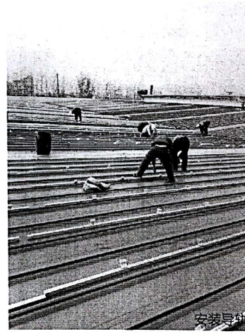
施工人员未穿戴劳保衣
