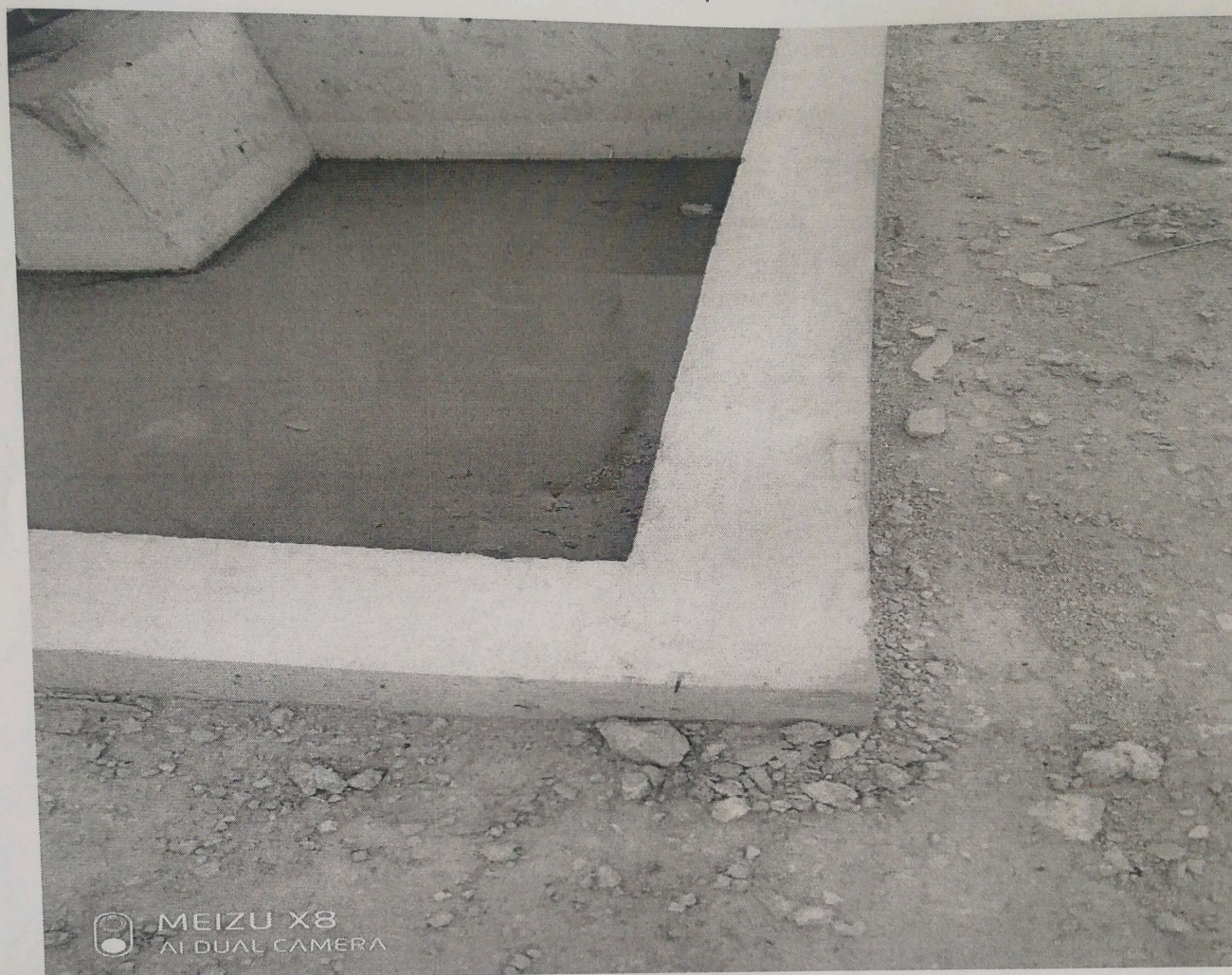
F32#机位箱变油池
