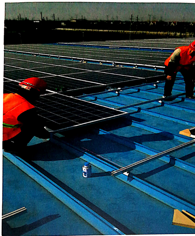
屋面四周未搭设临边防护
