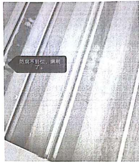
问题二：防腐不到位存在漏刷现象
