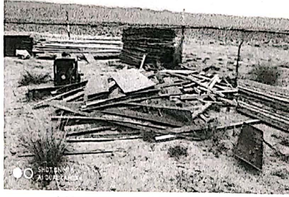
拆卸模板、木方散乱堆放
