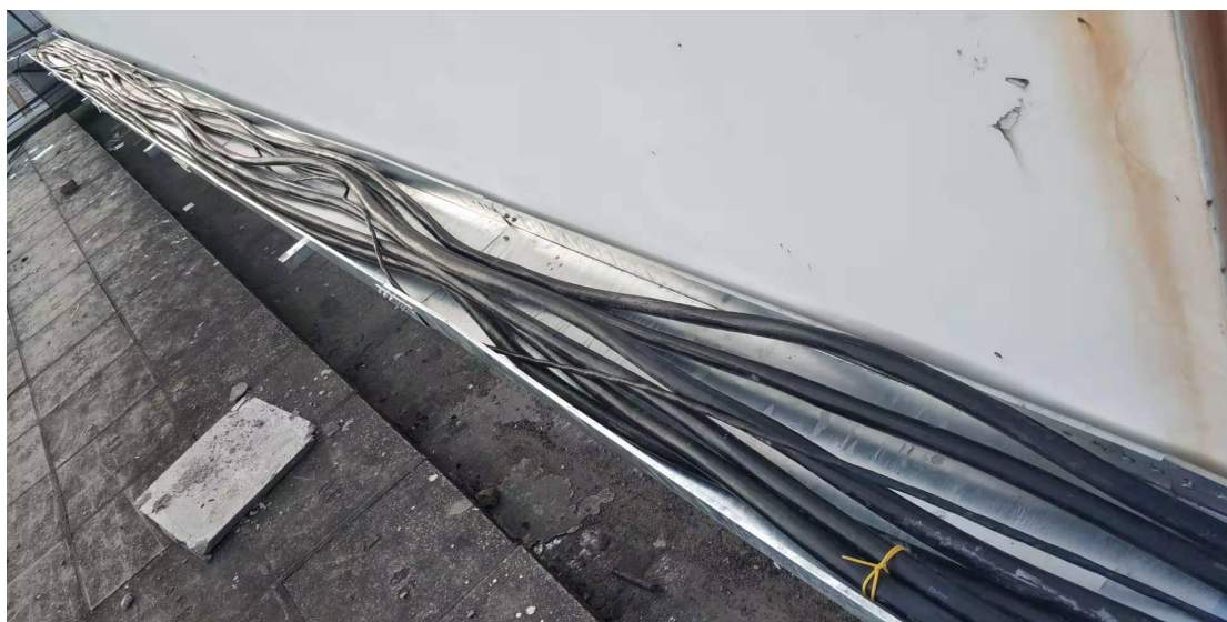
附图七：电缆敷设杂乱
