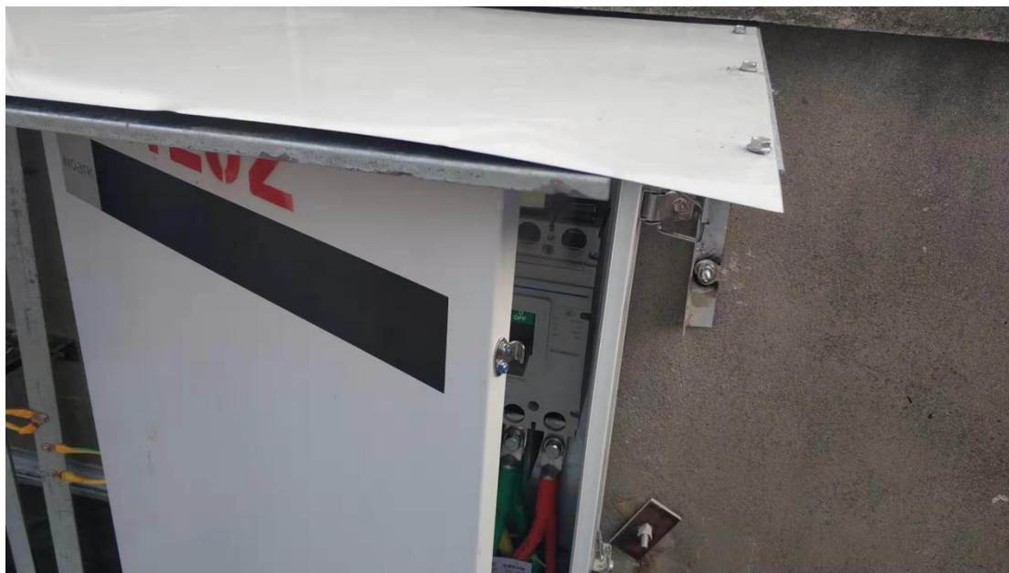
附图四：雨篷制作不规范，汇流箱门无法正常闭合
