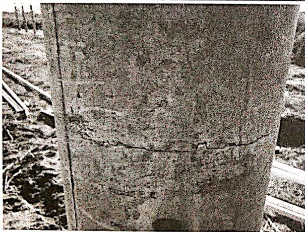
管桩环形裂缝
