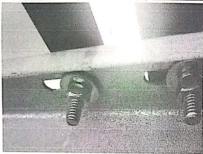
组件螺栓安装缺少弹垫
