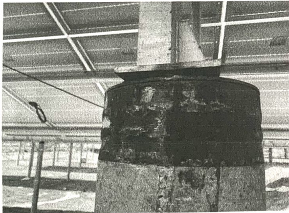
焊接面未焊接
