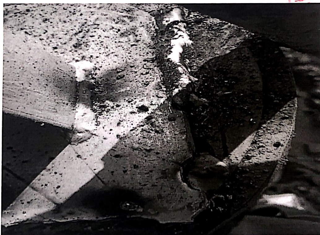
立柱焊接断焊、夹渣
