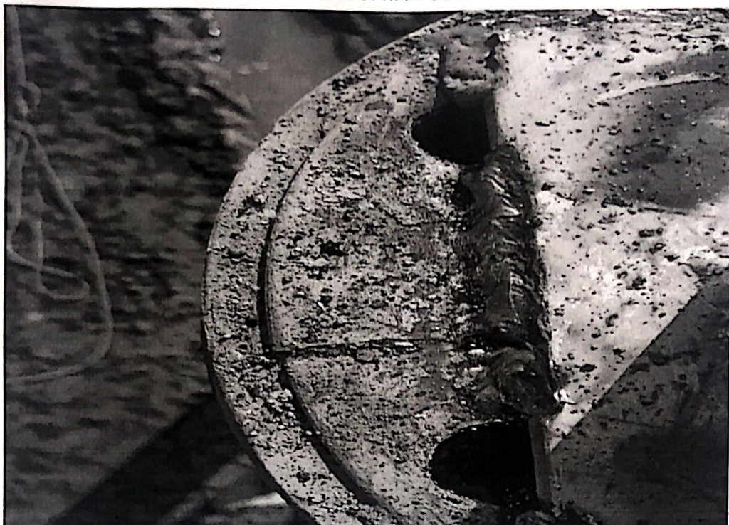
立柱焊接断焊、夹渣
