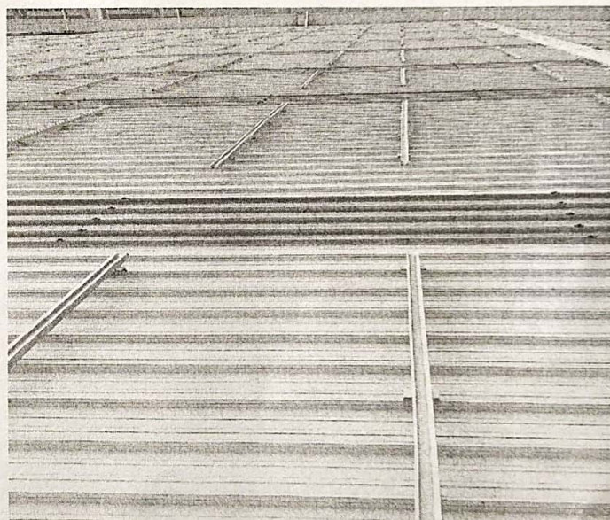
图二、檩条安装不统一已经整改
